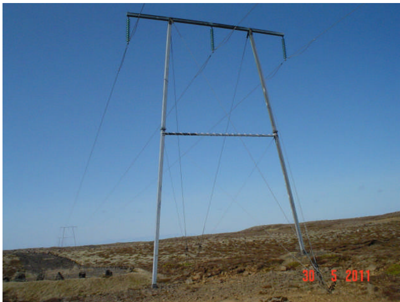
Mynd 4.1. Stagað stálstólpamastur í Reykjaneslínu, 132 kV.
